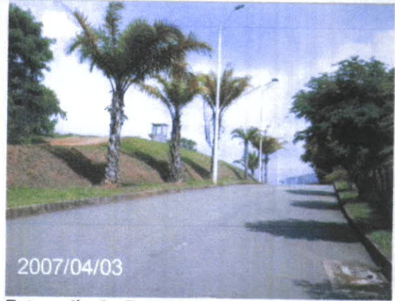
Fotografía 2. Estado de las vías de acceso. Prolongación Avenida Pasoancho.
