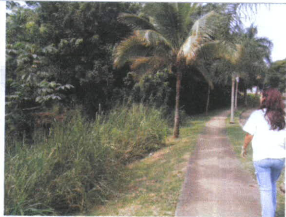
Fotografía 4. Estado de la vía peatonal perimetral. Lado Sur occidental.
