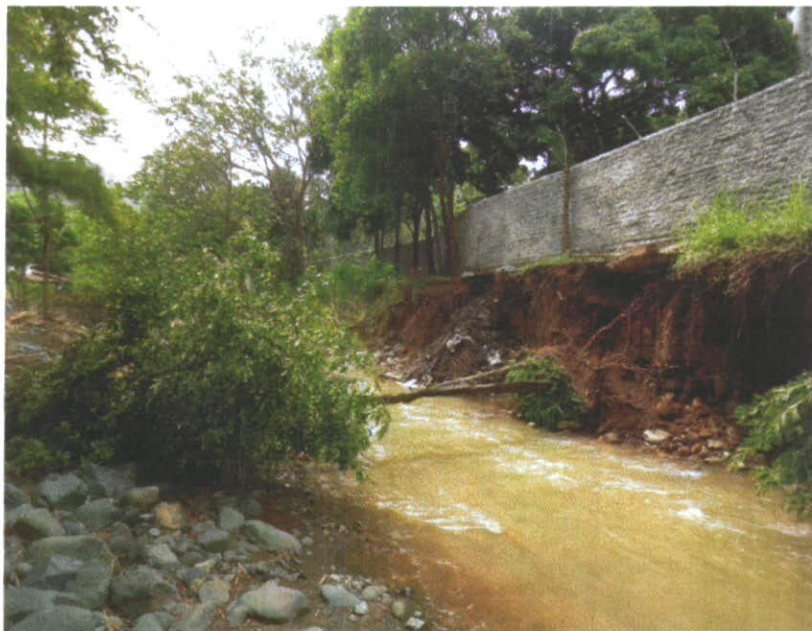
Fotografía 3-1 Vista del río Aguacatal hacia aguas abajo, se observa erosión marginal, árboles caídos y cerramientos en su orilla
